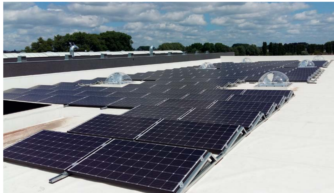
Dakisolatie, LightCatchers en zonnepanelen
