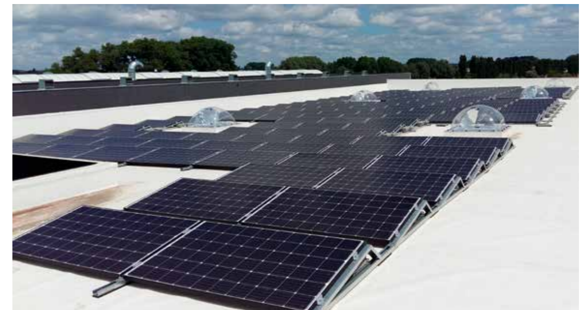
Dakisolatie, LightCatchers en zonnepanelen
